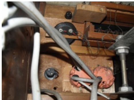
Blick in den Spieltisch auf die veraltete elektrische Anlage mit freiliegenden Anschlüssen (Ummantelungen bestehend aus Lackdraht)
